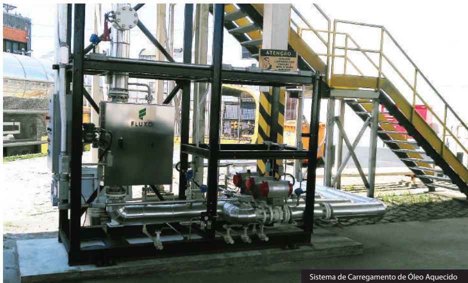
Sistema de Carregamento de Óleo Aquecido
