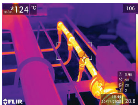
Levantamento e Certificação Termográfica do Aquecimento do Óleo
