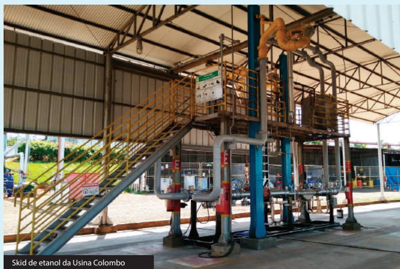
Skid de etanol da Usina Colombo
