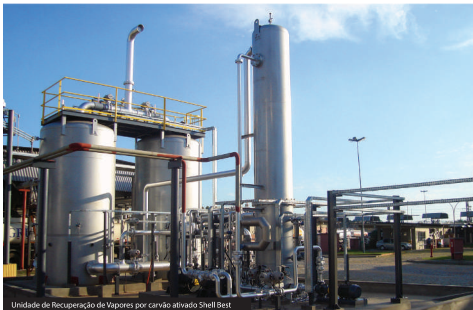
Unidade de Recuperação de Vapores por carvão ativado Shell Best
