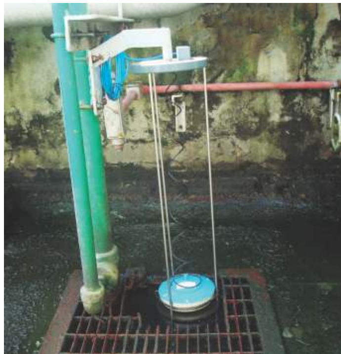
Sensor ID223/500 instalado em bacia de contenção na Unigel Guarujá
