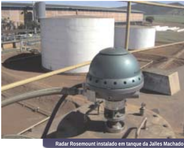
Radar Rosemount instalado em tanque da Jalles Machado
